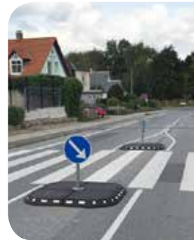
To helleanlæg monteret på 3 timer
